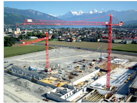
Obwohl auf festem Fundament stehend, ist ein Turmdrehkran ortsveränderlich. Vor der eigentlichen Kranarbeit müssen diese Krane erst ordnungsgemäß errichtet werden.
